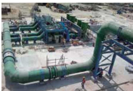
▶ Planta desaladora Az Zour South, Kuwait Diámetro (DN): 50 - 700 mm Longitud: 4,200 m
