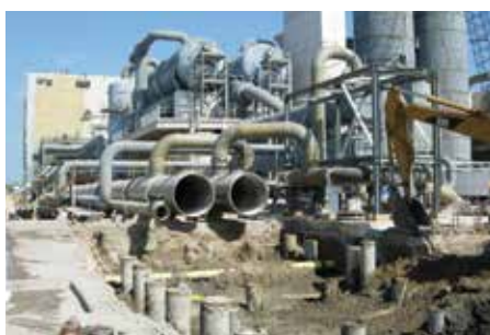
▶ Sistema de enfriamiento de agua Cantarell, México Diámetro (DN): 1,600 mm Longitud: 900 m
