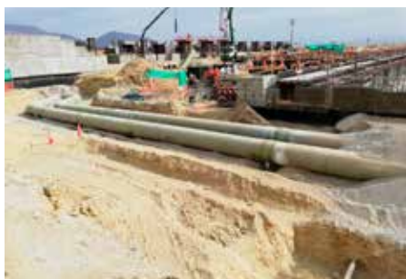
▶ Planta Desalinizadora Spence, Chile Diámetro (DN): 500 - 1,200 mm
