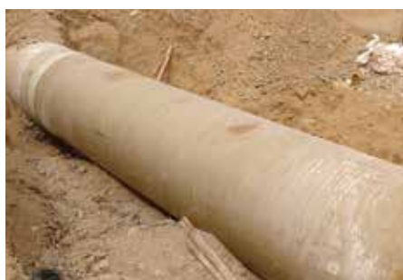
▶ Alcantarillado sanitario - EPS Grau, Chulucanas, Piura Diámetro (DN): 900 mm Longitud: 700 m
