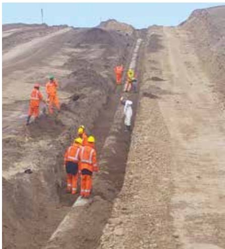
▶ Línea de conducción N° 1 Jaguay - Lomas de Ilo, Perú Diámetro (DN): 350 - 900 mm Longitud: 18,000 m
