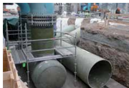
▶ Sistema de agua de enfriamiento - Planta de energía Arrubal, España Diámetro (DN): 1,600 mm Longitud: 300 m
