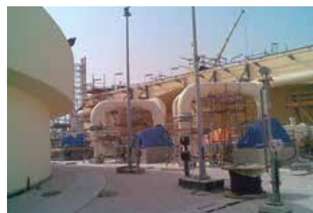
▶ Sistema de agua de procesos - Planta Ras Laffan, Qatar Diámetro (DN): 250 mm
