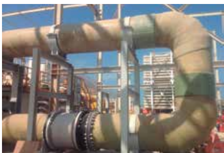
▶ Sistema de desalinización por ósmosis inversa - Minera Escondida, Chile Diámetro (DN): 25 - 1,200 mm
